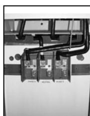
Utility lug landing
