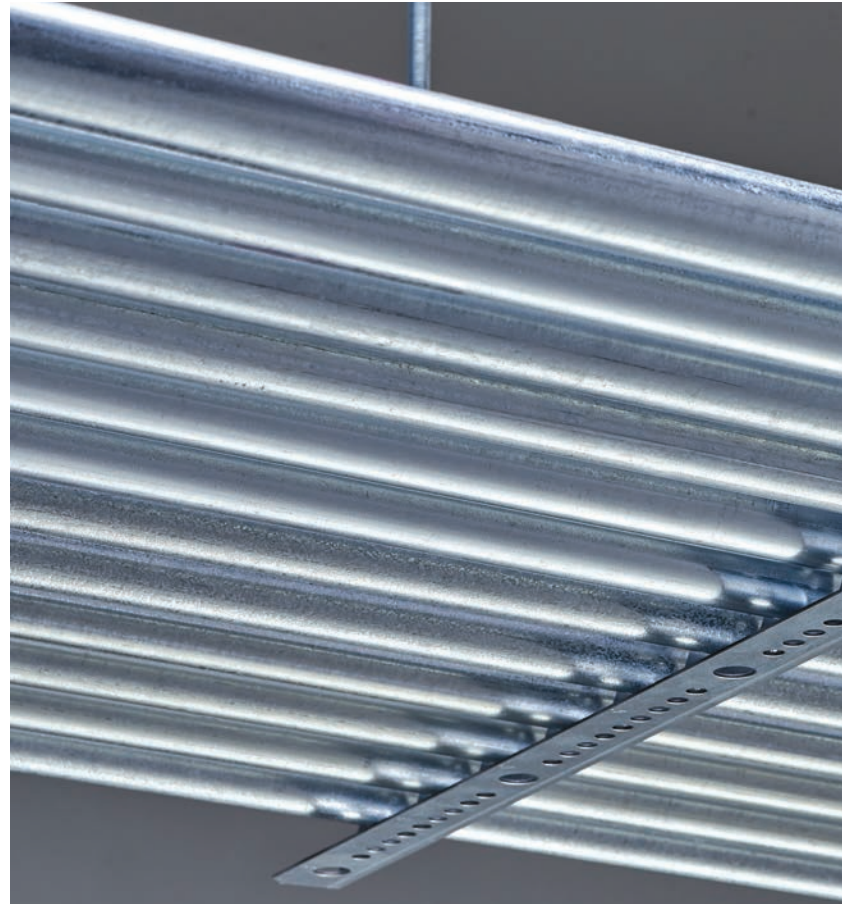
Conduit trapeze support
