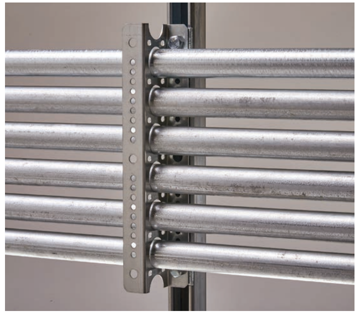
Horizontal conduit trapeze support
